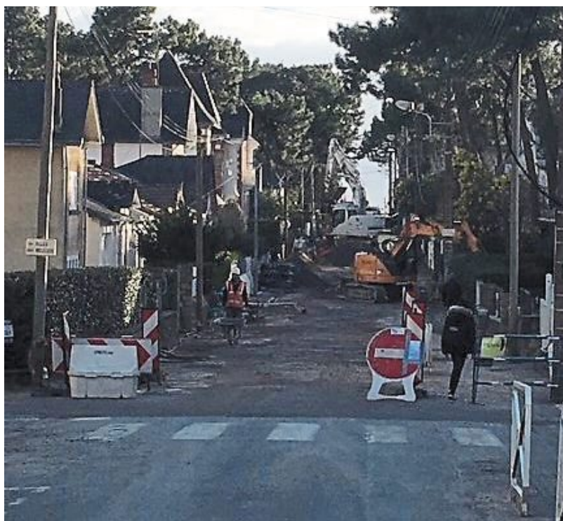
Pendant deux mois, des travaux de renouvellement des réseaux d'eau potable et d'assainissement des eaux usées se dérouleront dans l'avenue Pierre-Percée. | CREDIT PHOTO : OUEST-FRANCE
